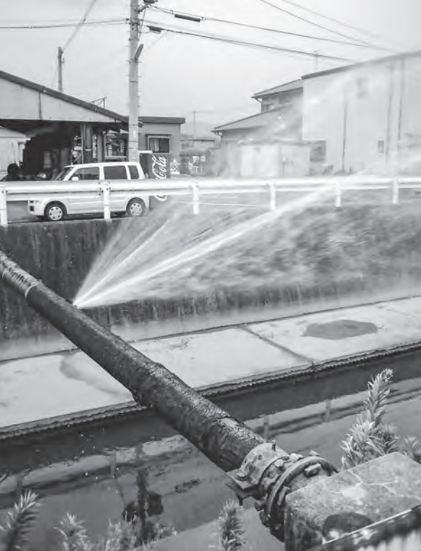
↑川の上を横断している水道管が破裂し、水が勢いよく吹き出す様子。もし、同じことが道路に埋設された水道管で起きたらどうなるでしょう……。
