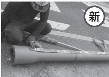
↑新品の鑄鉄製水道管。地震に強く接合部が外れにくい構造で、表面には長持ちさせるための特殊塗装も施されています。
