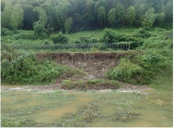
農地の法面が崩落した。
