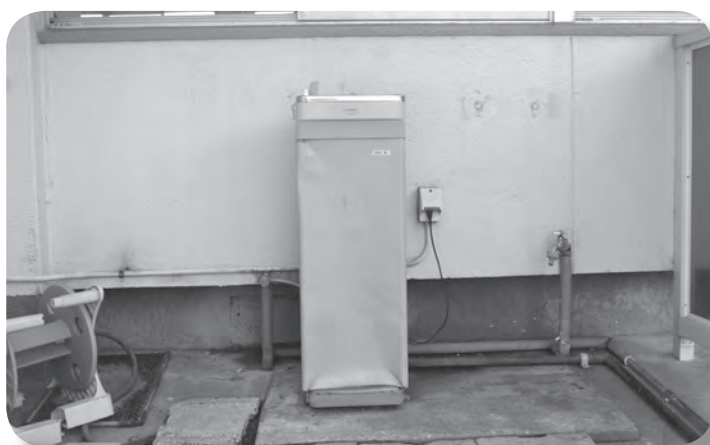
遠賀中学校に設置してある冷水機
