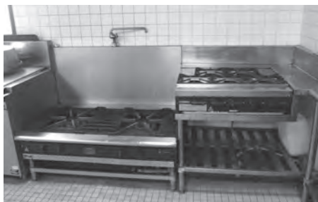
老朽化したガスレンジ
