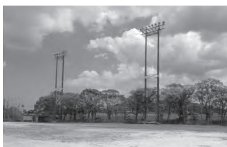
LEDに交換される照明設備
