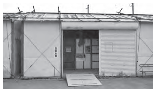
老朽化したふれあい農園の倉庫
