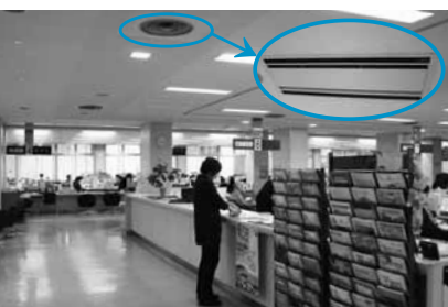
改修が行われる庁舎1階の空調
