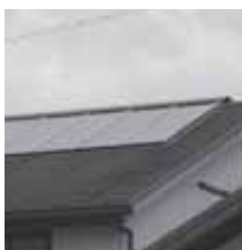
住宅用太陽光発電設備
