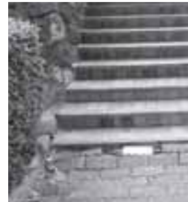
劣化個所の一部
