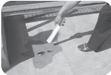
屋上防水シート破損箇所の一部 (浅木小学校)
