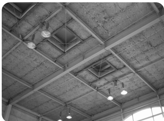
▲第二町民体育館天井
