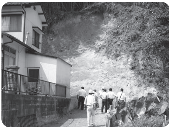
▲がけ崩れ箇所（千代丸）
