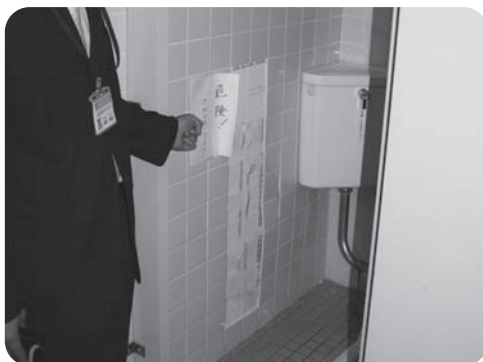
▲タイルのはく離箇所
