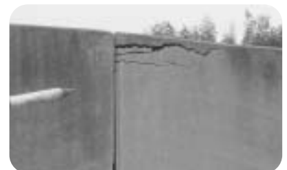
L型擁壁に生じたクラック
