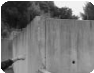
段差が生じたL型擁壁
