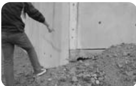
むき出しになった基礎部分
