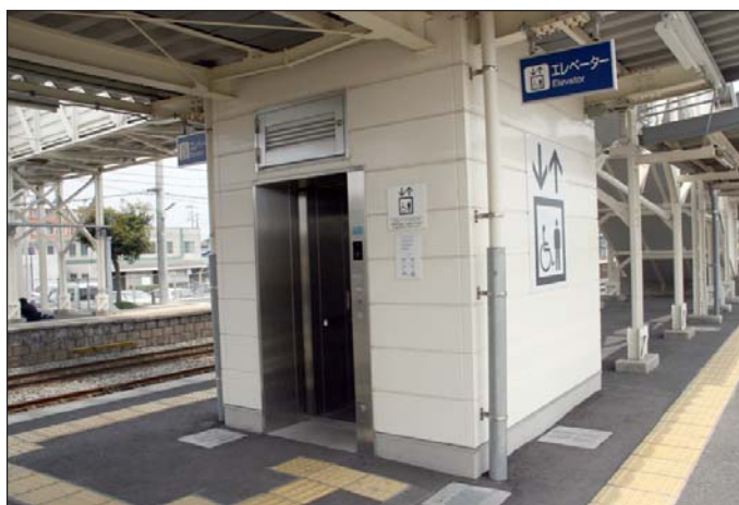
◆ JR 遠賀川駅のホームに設置されたエレベーター◆
