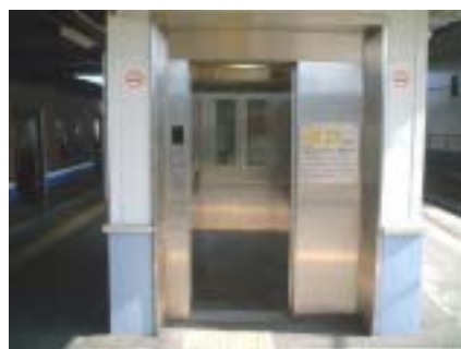
エレベーターの設置例
