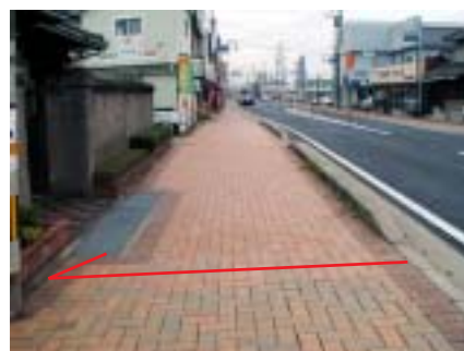
横断こう配が大きいと車いすで直進が困難になる
