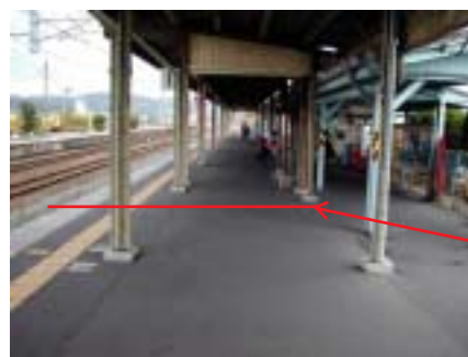
ホームをかさあげしたため、改札口からホームまでにこう配が生じている
