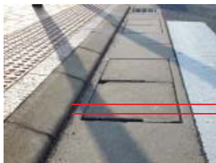
横断歩道部分の段差
