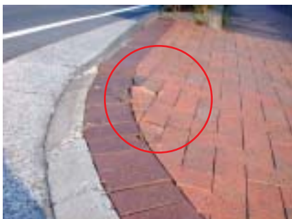
ブロックの浮き上がり
