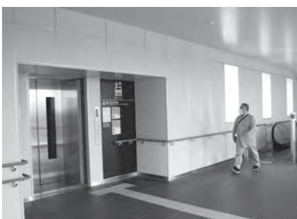
▲エスカレーターとエレベーターでバリアフリー
