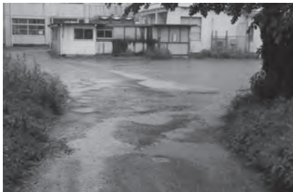
雨天時に冠水する浅木小西門付近
