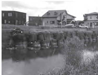
若松地区護岸崩落の現場
