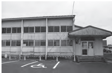
老朽化し、使用されていない武道場
