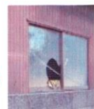
窓が割れた 管理不全空家
